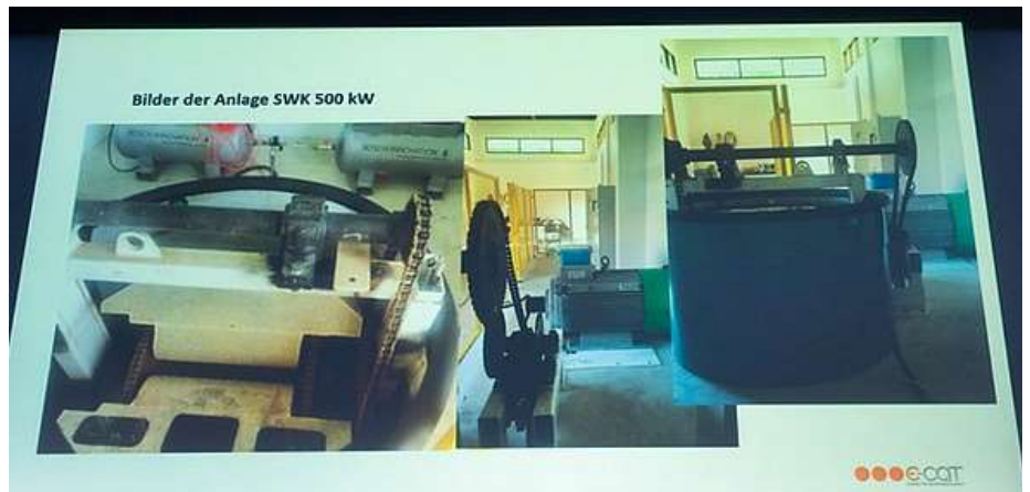
Auftriebskraftwerk in Thailand: Blick auf den oberen Teil der Röhre, die 25 m in die Tiefe reicht. Oben links sieht man die zwei 4-kW-Kompressoren der 500-kW-Anlage. Im rechten Teil ist die Achse mit den Zahnrädern erkennbar, über die die mechanische Energie nach mehrfacher Übersetzung auf den Generator geleitet wird.
